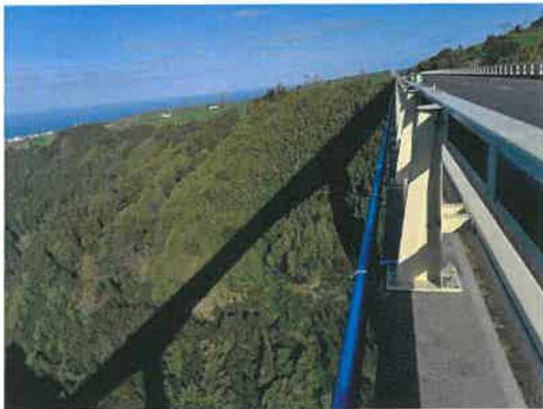
Foto adutora numa das pontes da Euroscut
