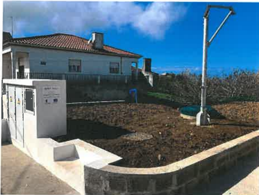
Foto estação elevatória
