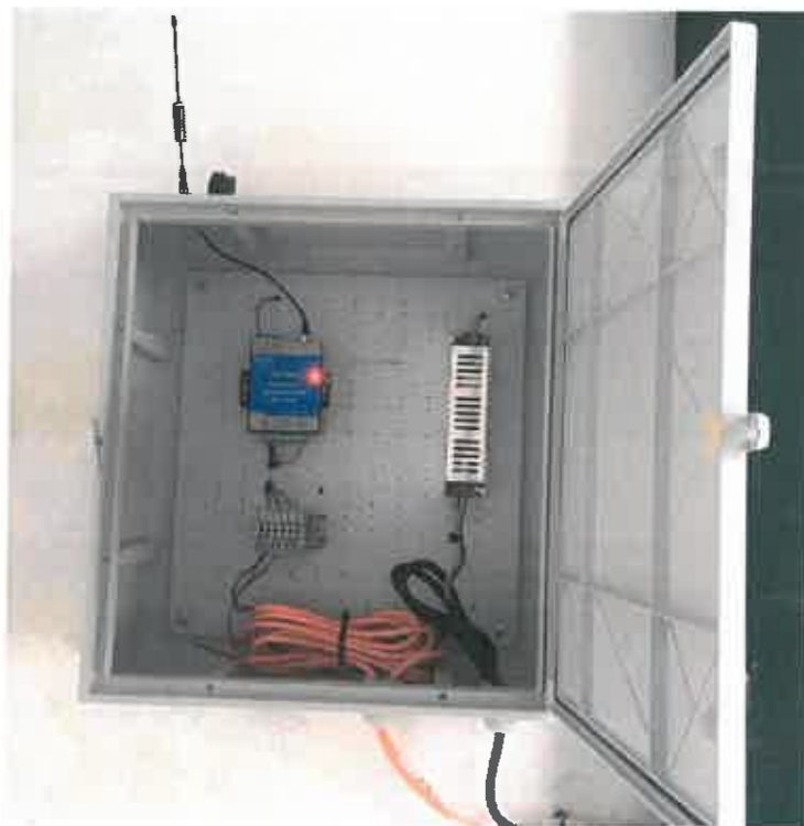
Foto equipamento de telemetria instalado num dos reservatórios
